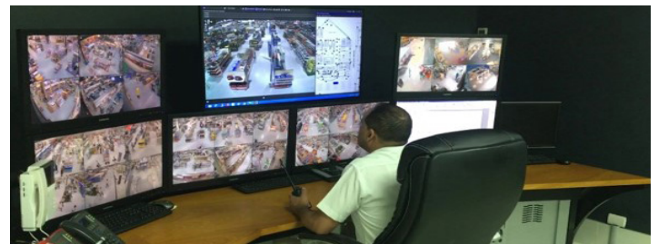
Estacion de monitoreo central de Ferretería Ochoa
