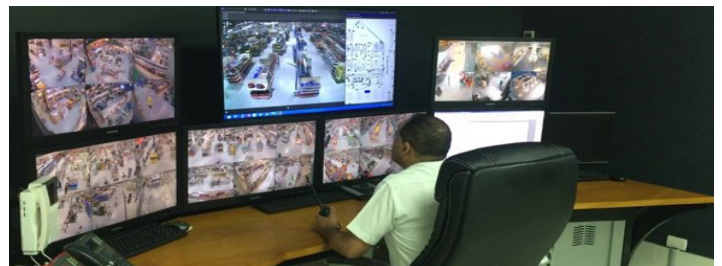
Ferretería Ochoa central monitoring station
