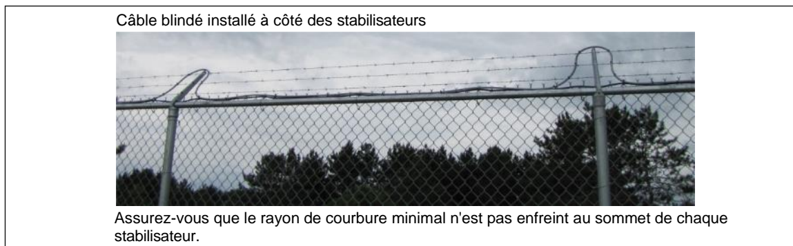
Figure 51 : Installation d'un câble capteur blindé sur un fil barbelé
