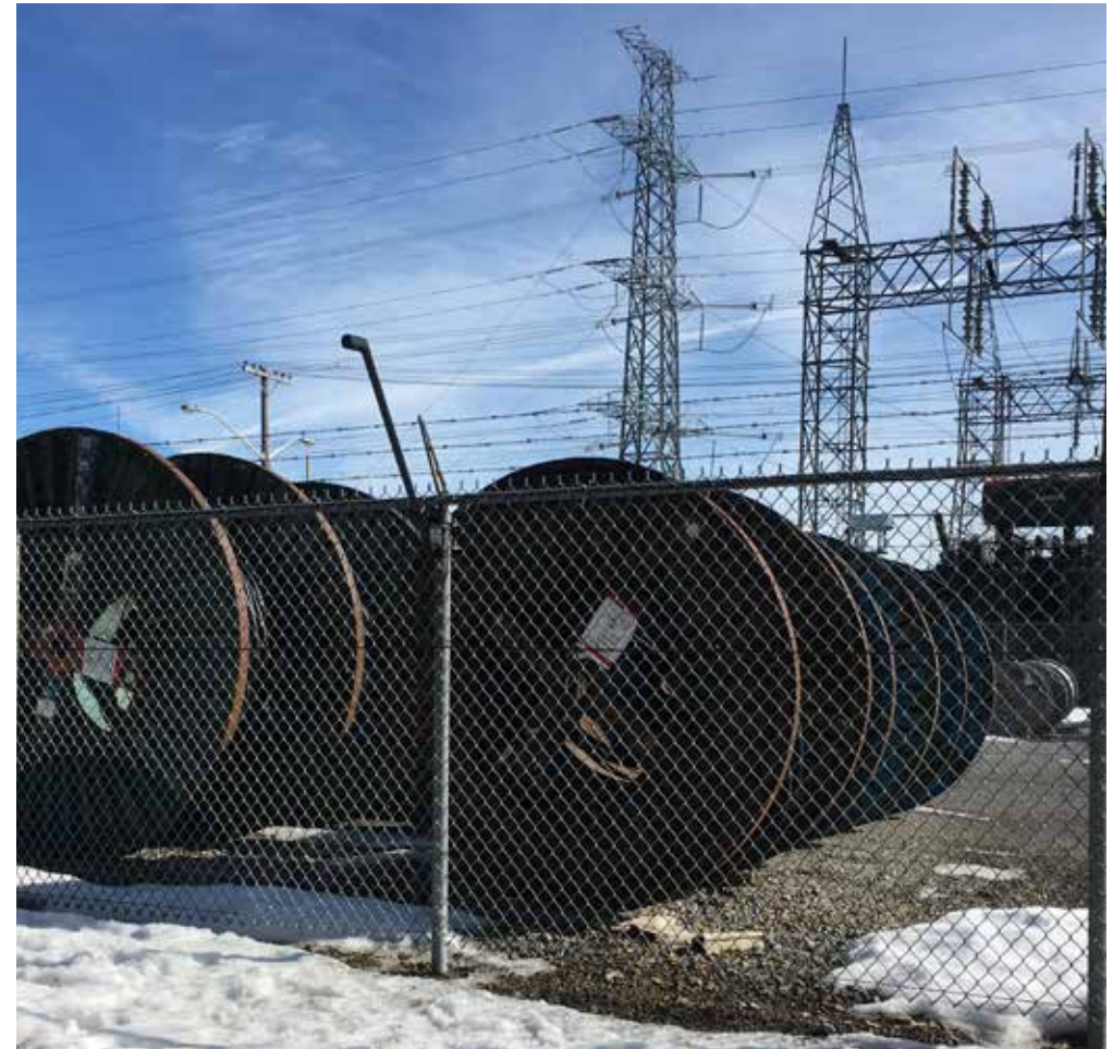
Ein Lagerplatz für Elektrokabel wird von Senstar LM100 geschützt. Das hybride System erkennt Einbrüche und sorgt gleichzeitig für ausreichend Beleuchtung bei Nacht.
